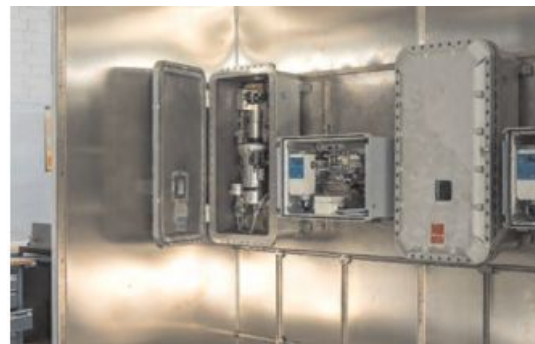
图 8 CWD2000 EX 设备使用在防爆区域现场。
